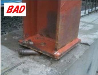
アンカーボルトが 泣いています…
